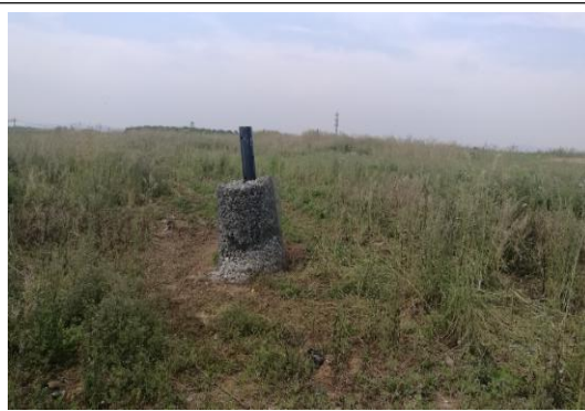
垃圾堆体的导排气管道
