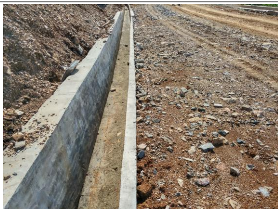
运输道路排水沟
