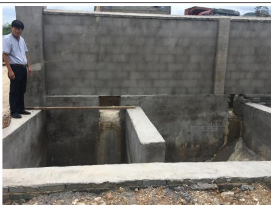
工业场地二级沉淀池
