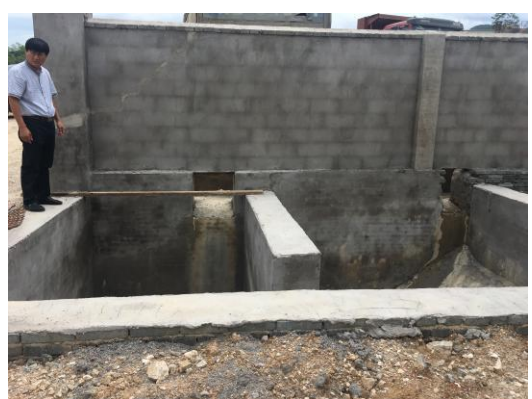
工业场地二级沉淀池
