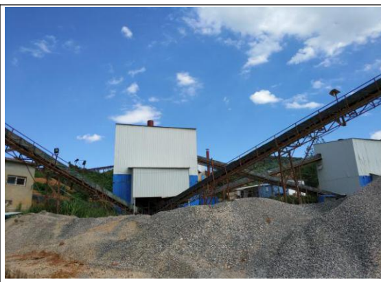
破碎站及运输廊道密封
