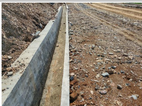
运输道路排水沟
