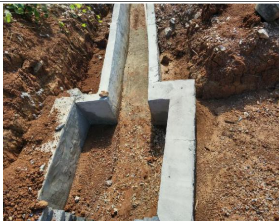
运输道路侧沉砂池
