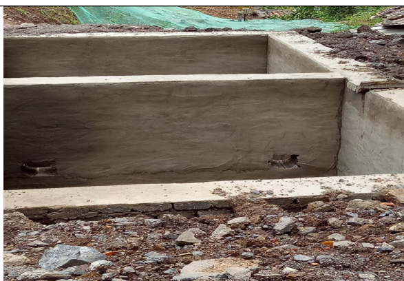
矿石加工区沉沙池 1
