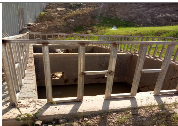
矿石加工区沉沙池 2
