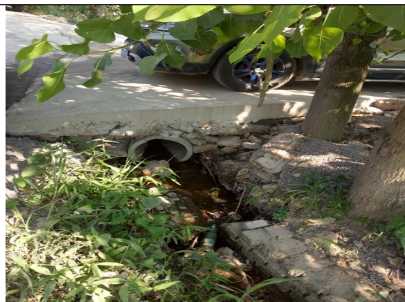
排水沟及过路涵管
