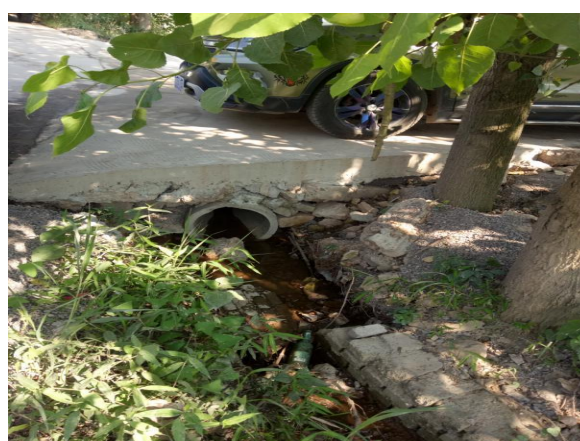
排水沟及过路涵管
