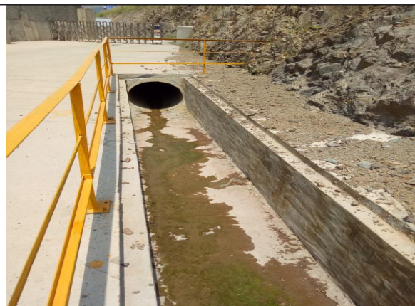
排水沟及过路涵管
