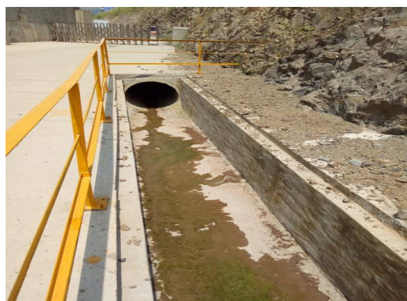
排水沟及过路涵管
