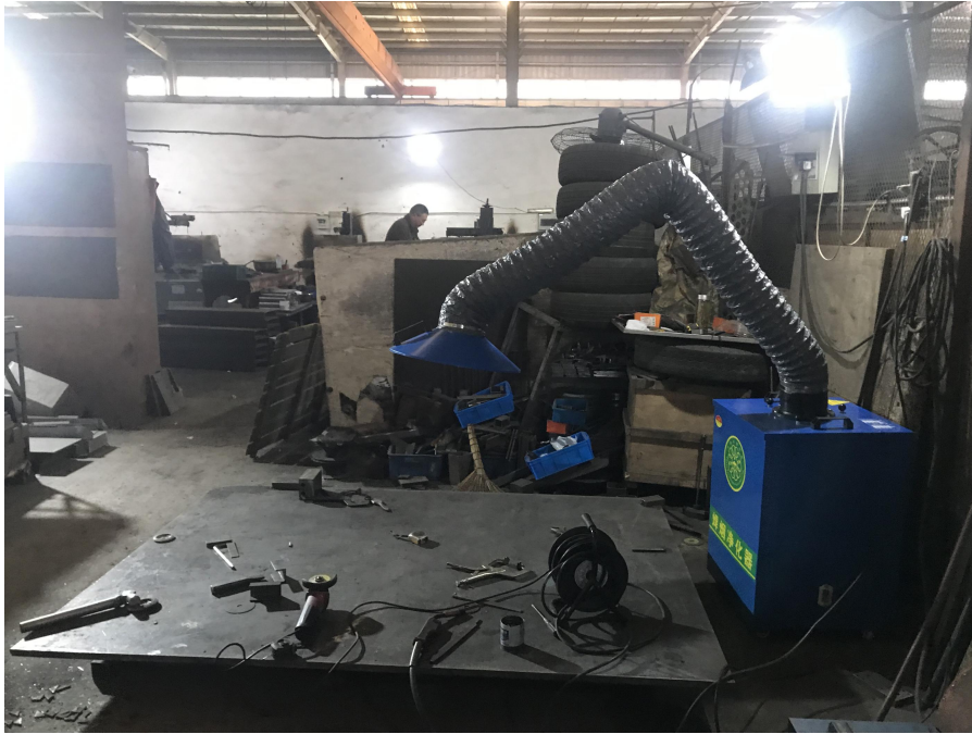
图 3-1 项目焊接烟尘净化处理装置
