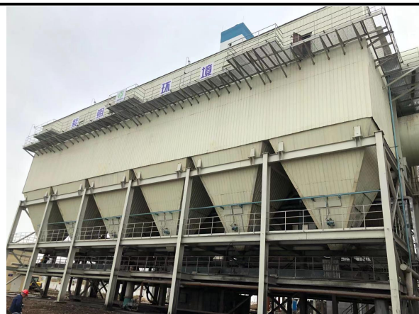
脱硫脱硝除尘一体化设施
