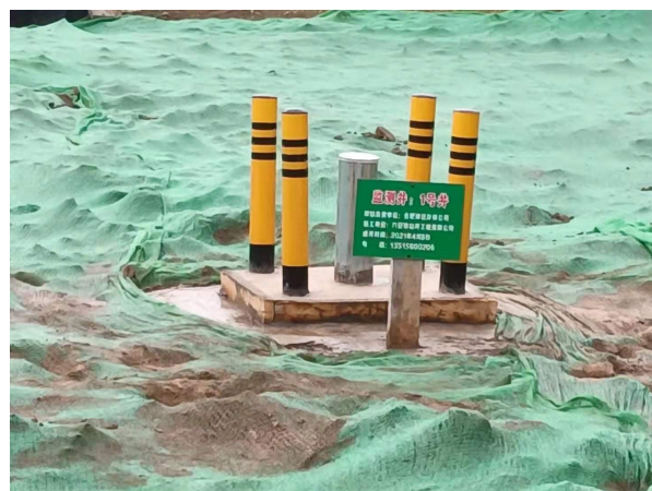
DW1 地下水监测井
