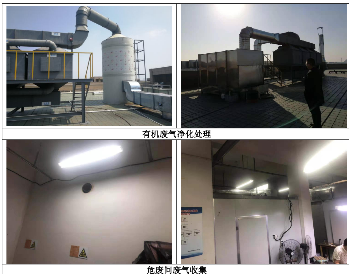
图 4.1.2-2 废气处理措施
