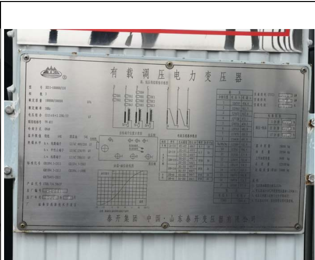
升压站 2#主变铭牌
