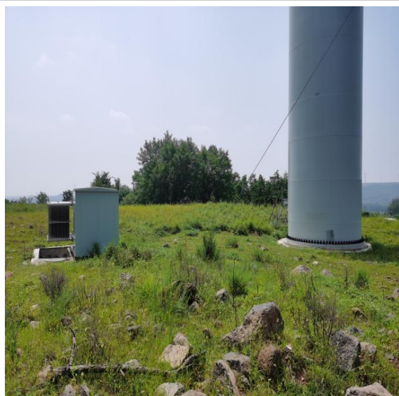
F07 号风机机组现状
