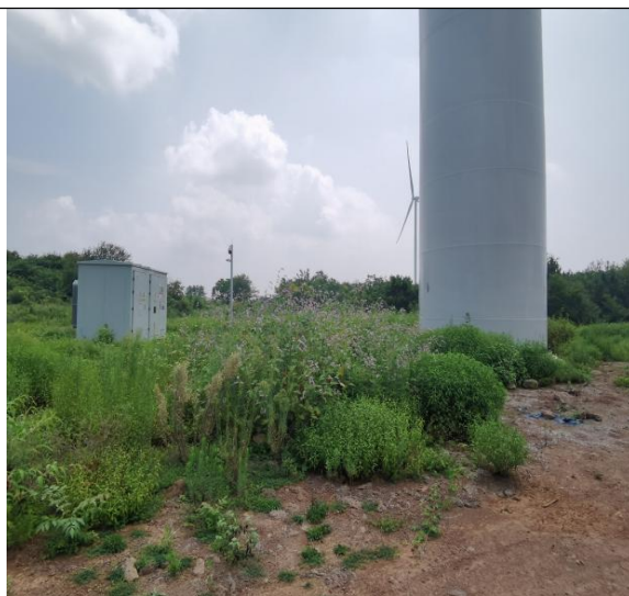
F09 号风机机组现状
