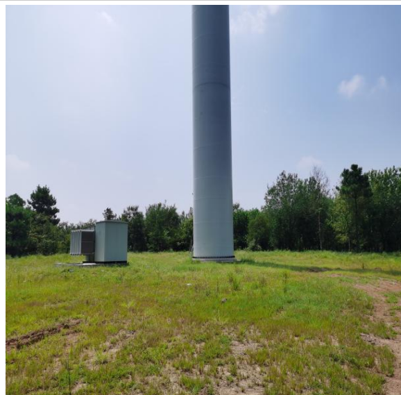
F08 号风机机组现状
