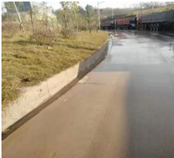
运输道路一侧排水沟
