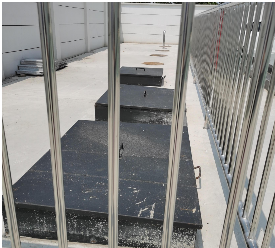
生活废水处理一体化设施
