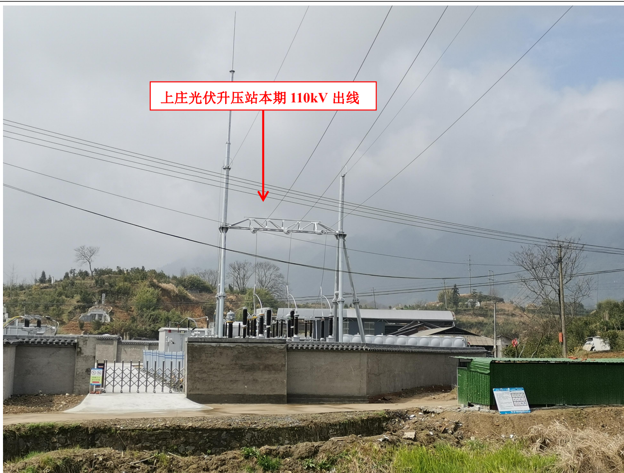
图 4-3 110kV 上庄光伏升压站出线现场图片
