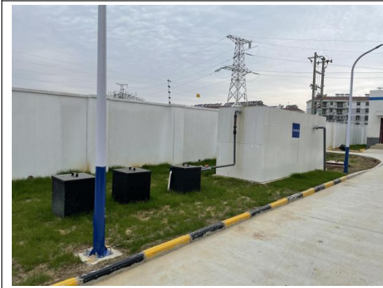
一体化污水处理设施
