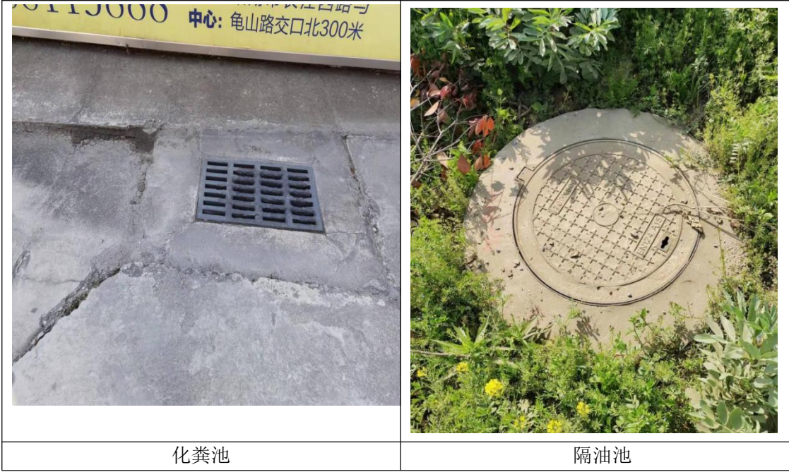
图 3.2-1 现有废水污染防治设施
