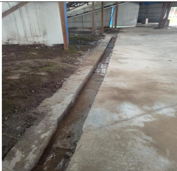
矿石加工区排水沟
