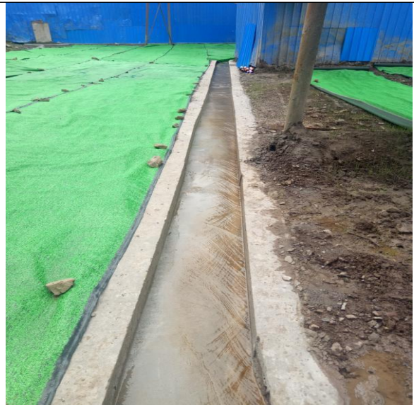
矿石加工区排水沟 2
