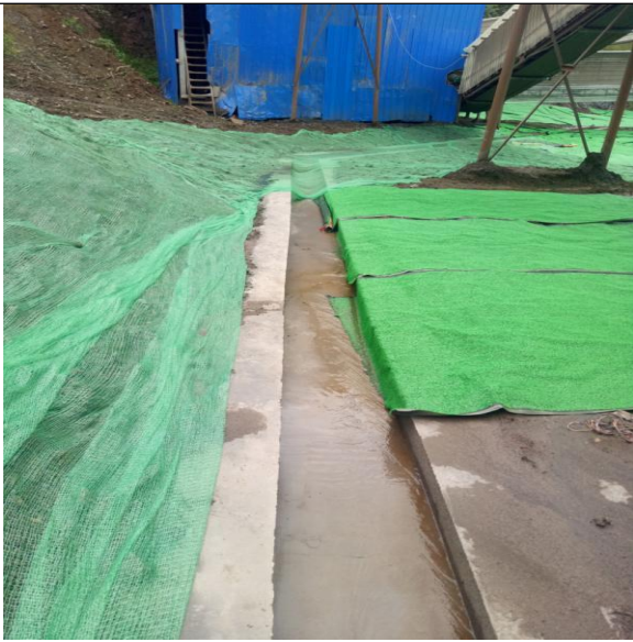
矿石加工区排水沟 1
