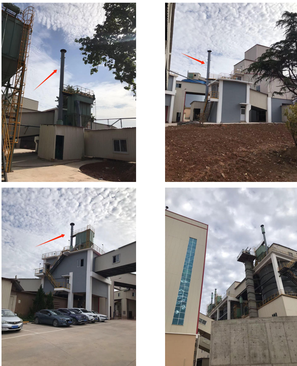
图 3-1 废气治理设施图
