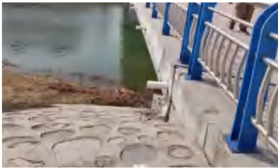
桥梁排水设施
