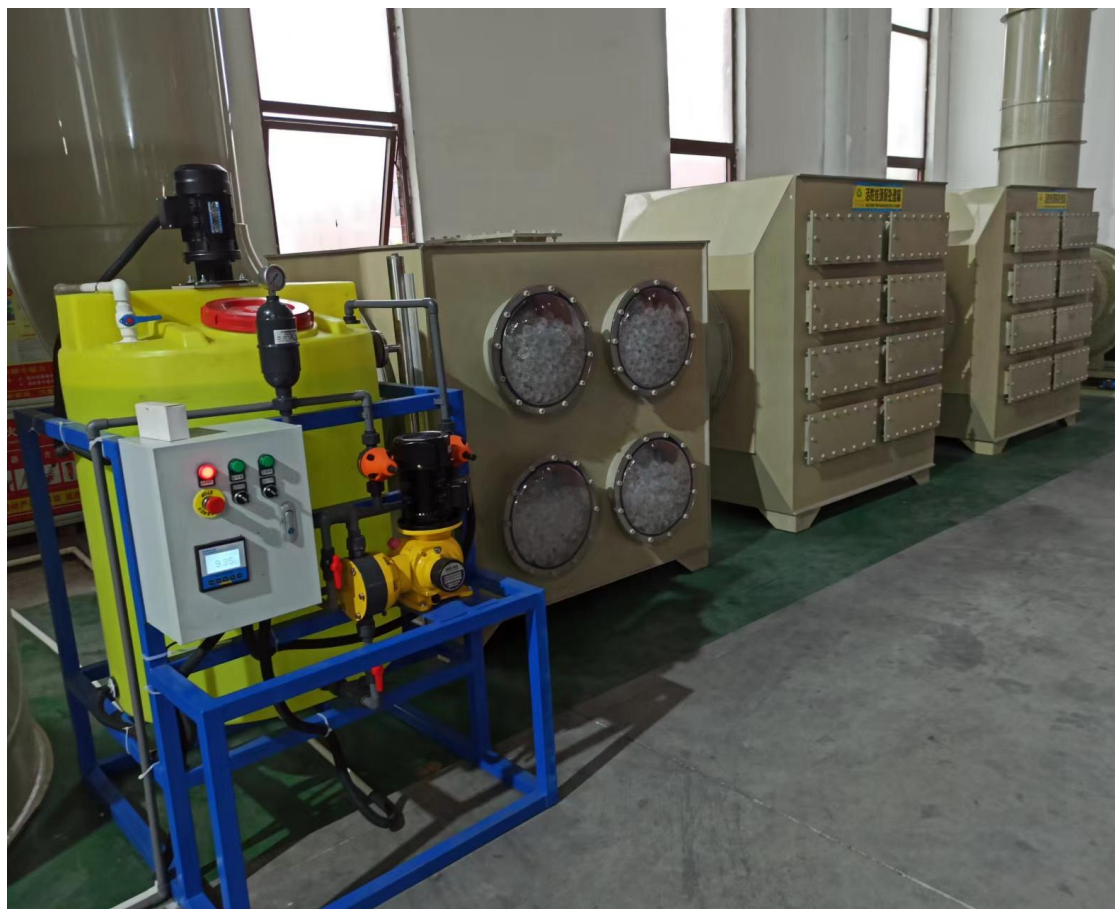
图 3-7 除雾箱、两级活性炭吸附箱、玻璃钢离心风机（污水站及危废库废气处理）
