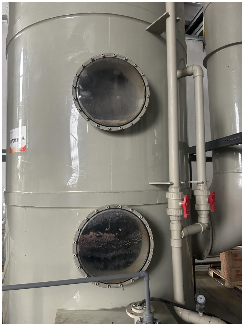
图 3-1 碱液喷淋（注液废气处理）
