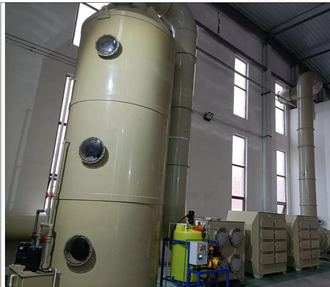
图 3-5 碱洗+两级活性炭吸附（污水站及危废库废气处理）
