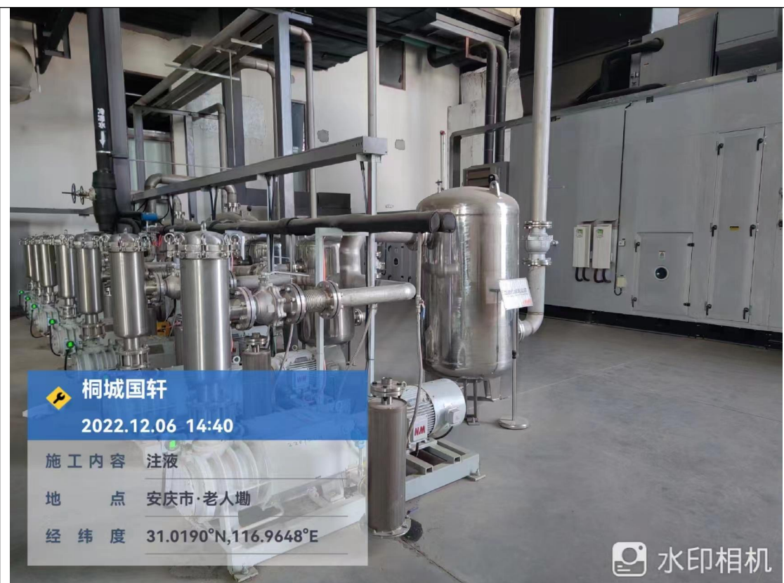
图 3-3 注液废气车间
