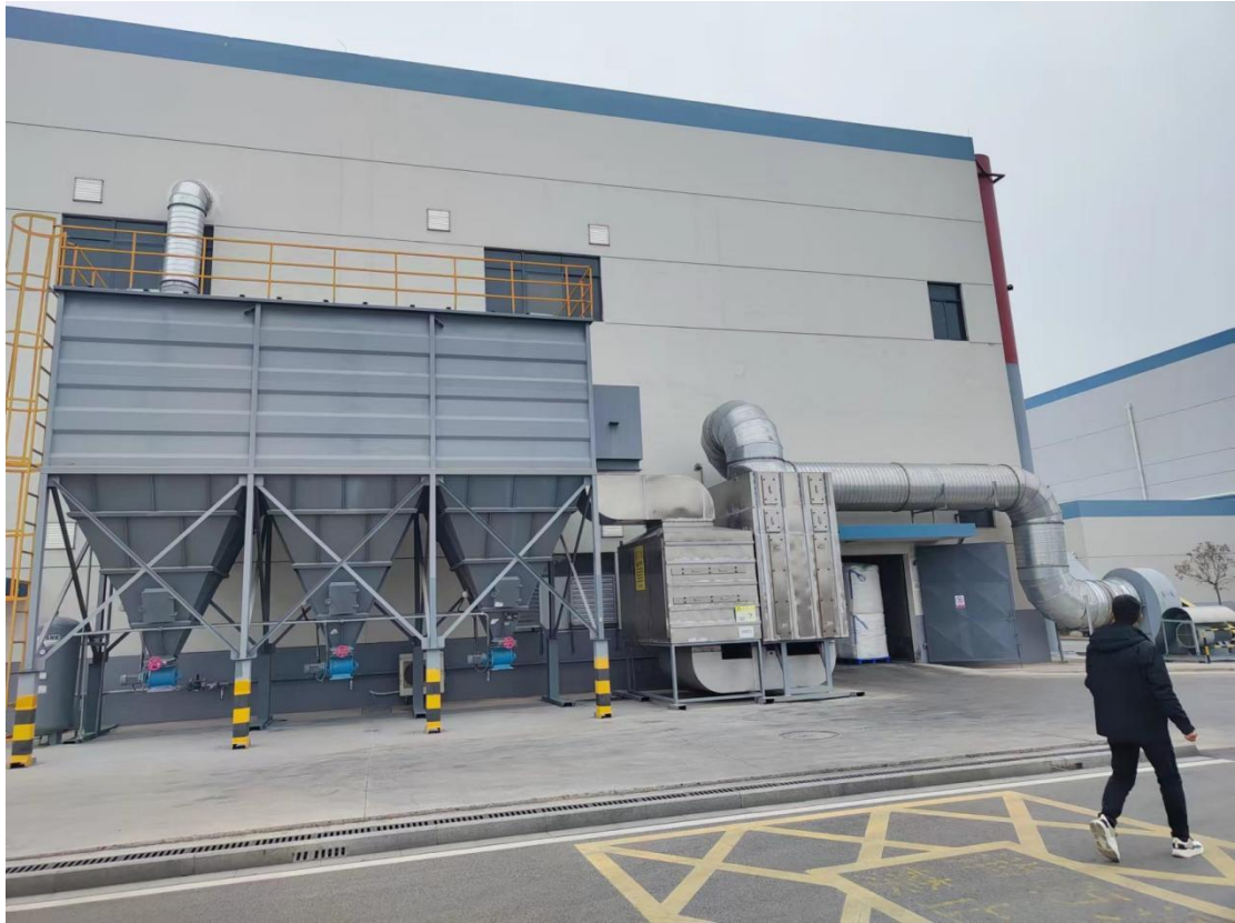
图 4.1-2 混炼胶车间废气治理设施
