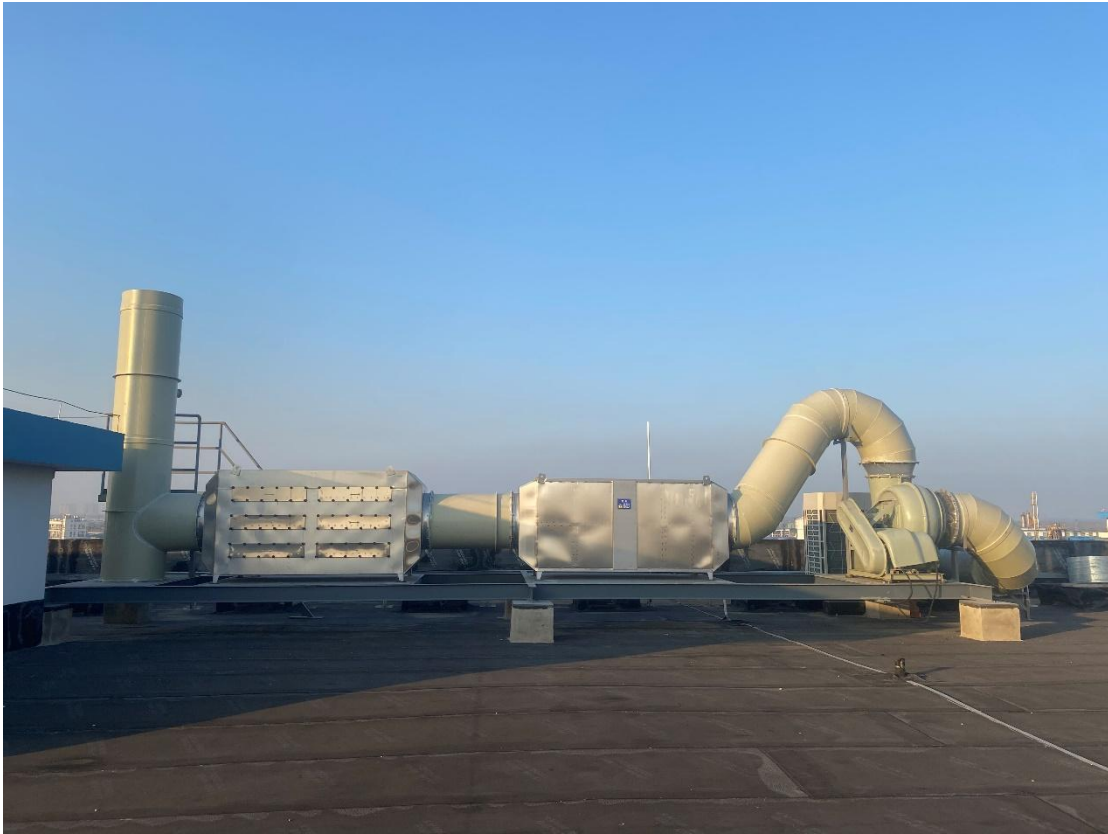
图 4.1-6 实验废气治理设施
