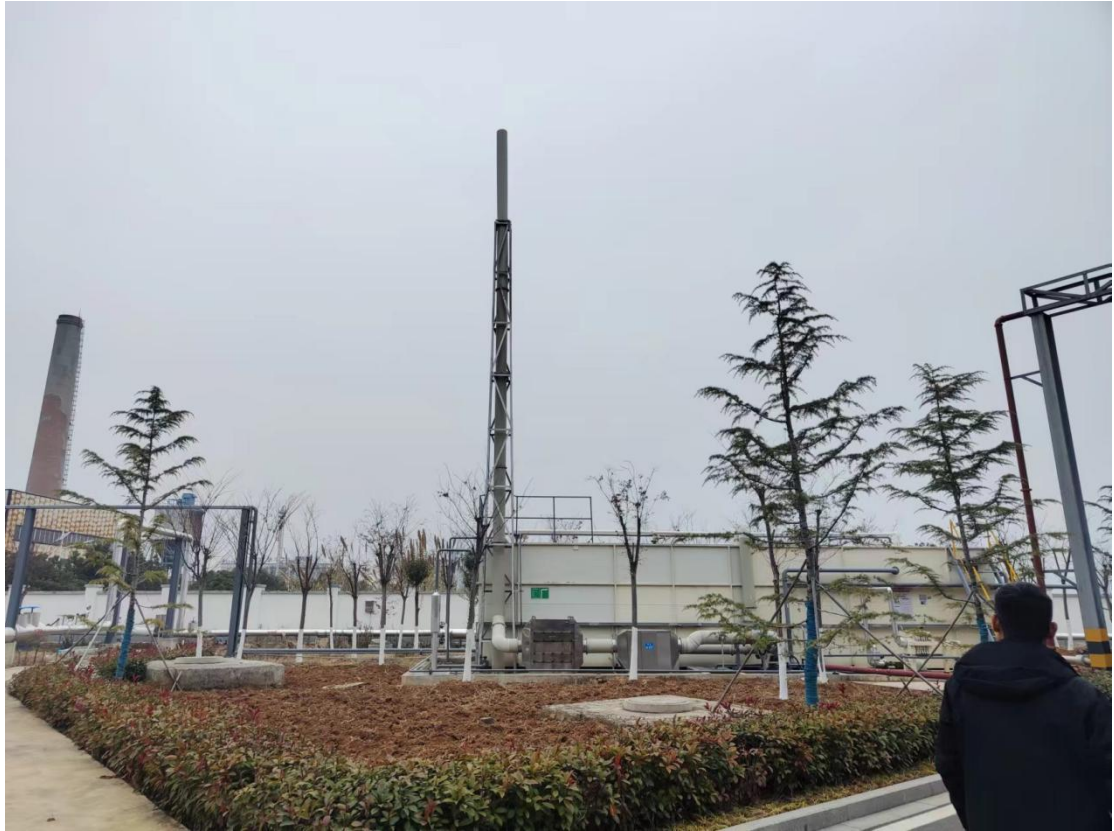
图 4.1-5 污水处理站废气治理设施
