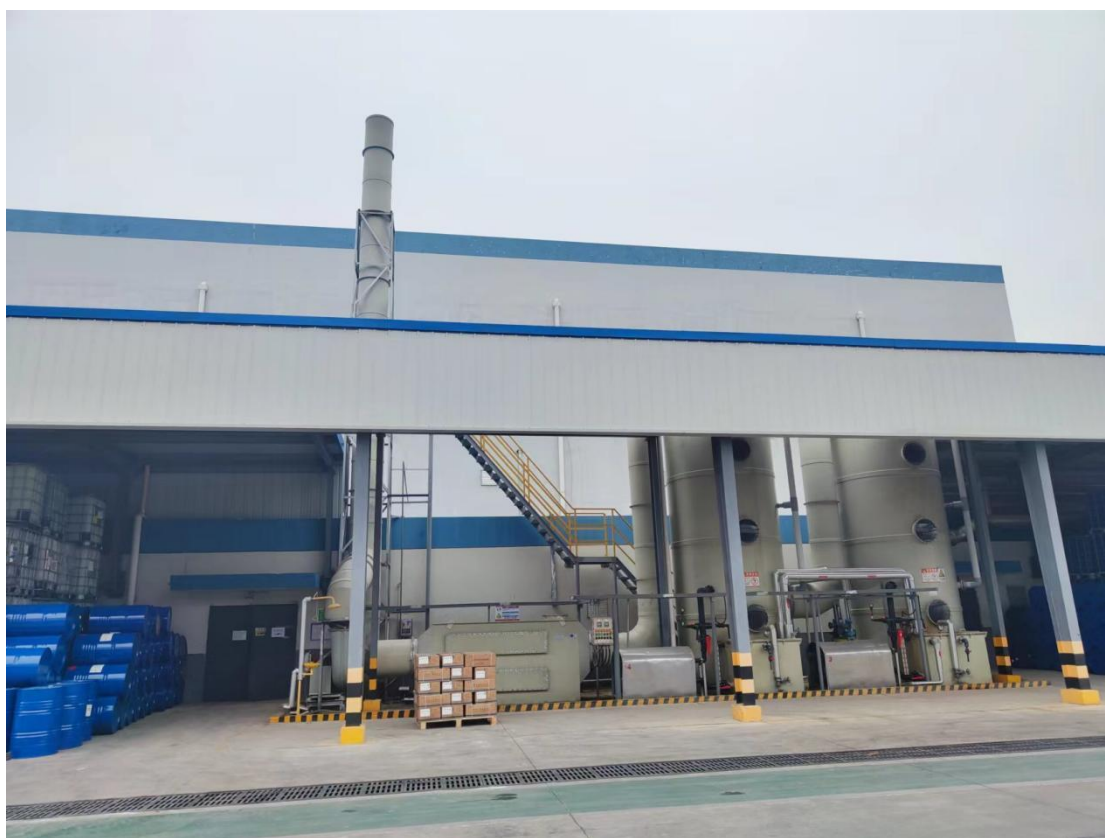
图 4.1-1 生胶车间（西）废气治理设施
