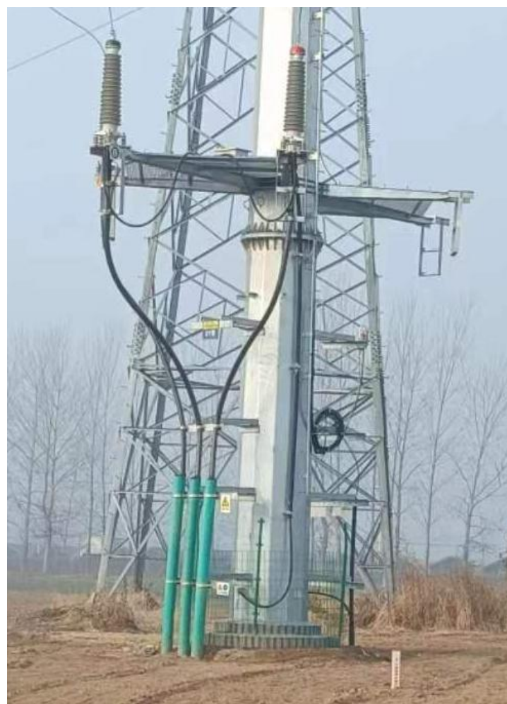
塔基警示标牌
