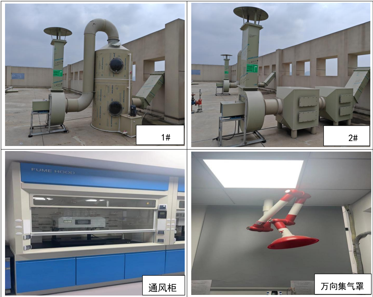
图 3-3 废气治理设施图片
