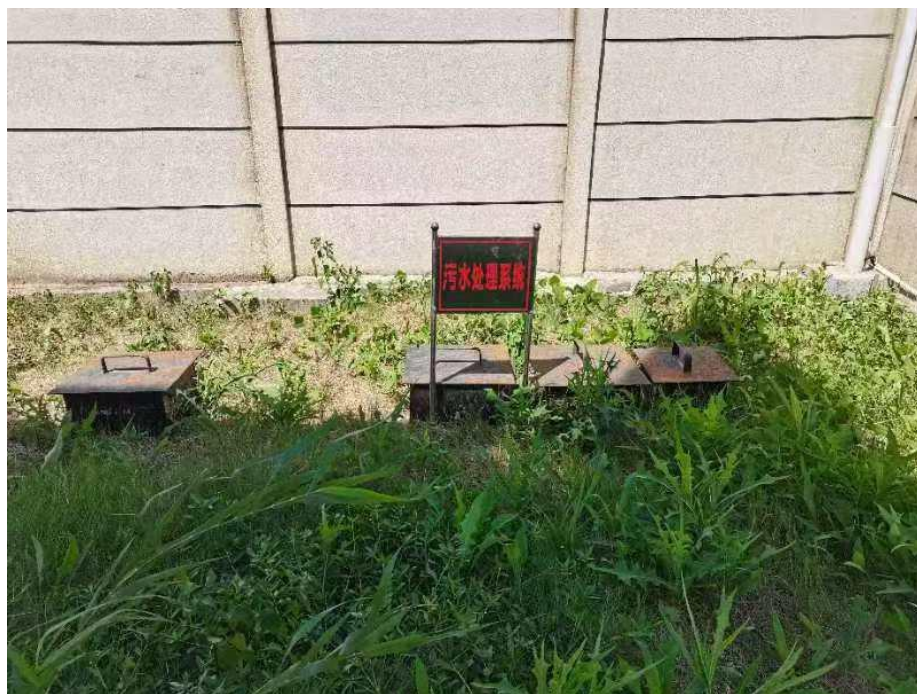
生活废水处理一体化设施
