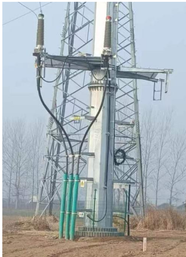
塔基警示标牌
