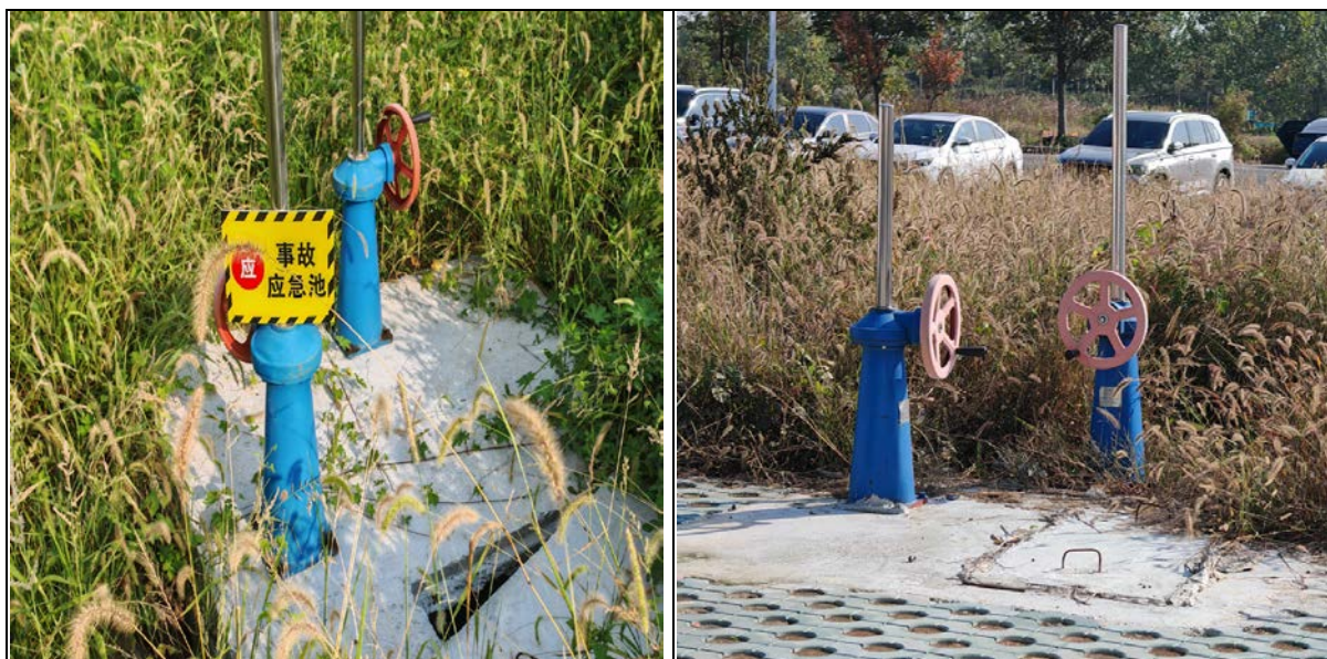
图 3.5 事故应急池及切换阀门
