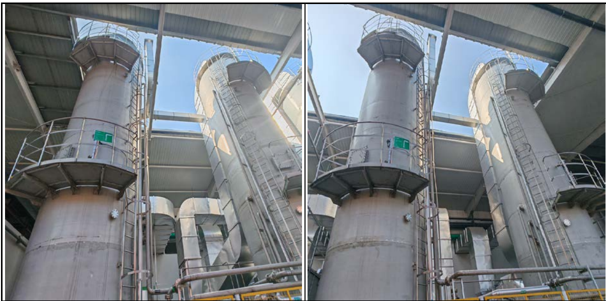
涂布废气处理设施
