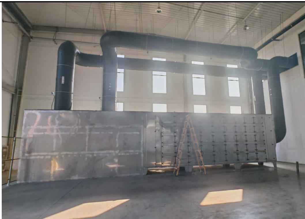
注液废气处理设施
