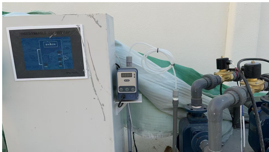
生活废水处理一体化设施
