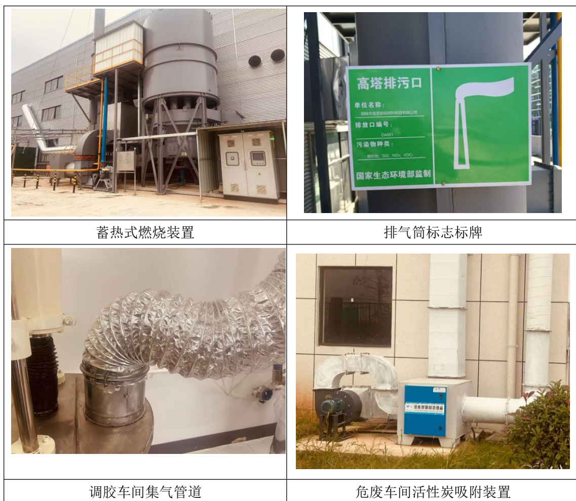
图 4.1-3 废气污染防治措施照片
