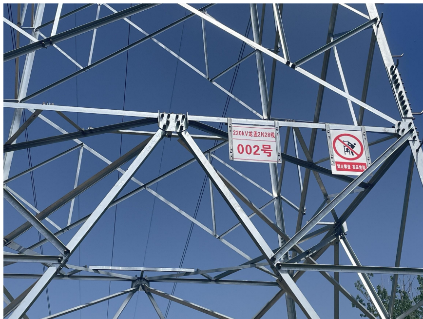
塔基警示标牌
