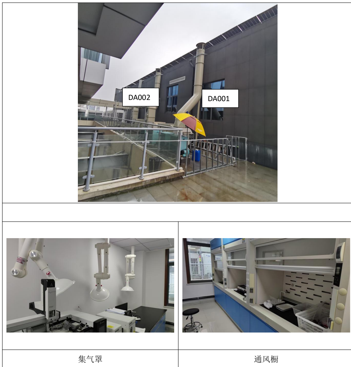
图 3-1 废气处理设施照片
