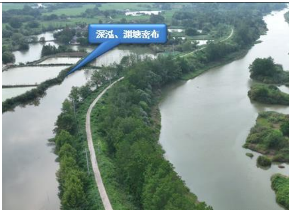
图 2-6 保丰圩段堤防现状问题 2
