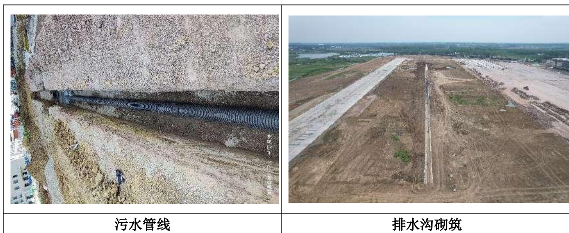
图 4.1-1 本项目施工期废水处理措施现场照片
