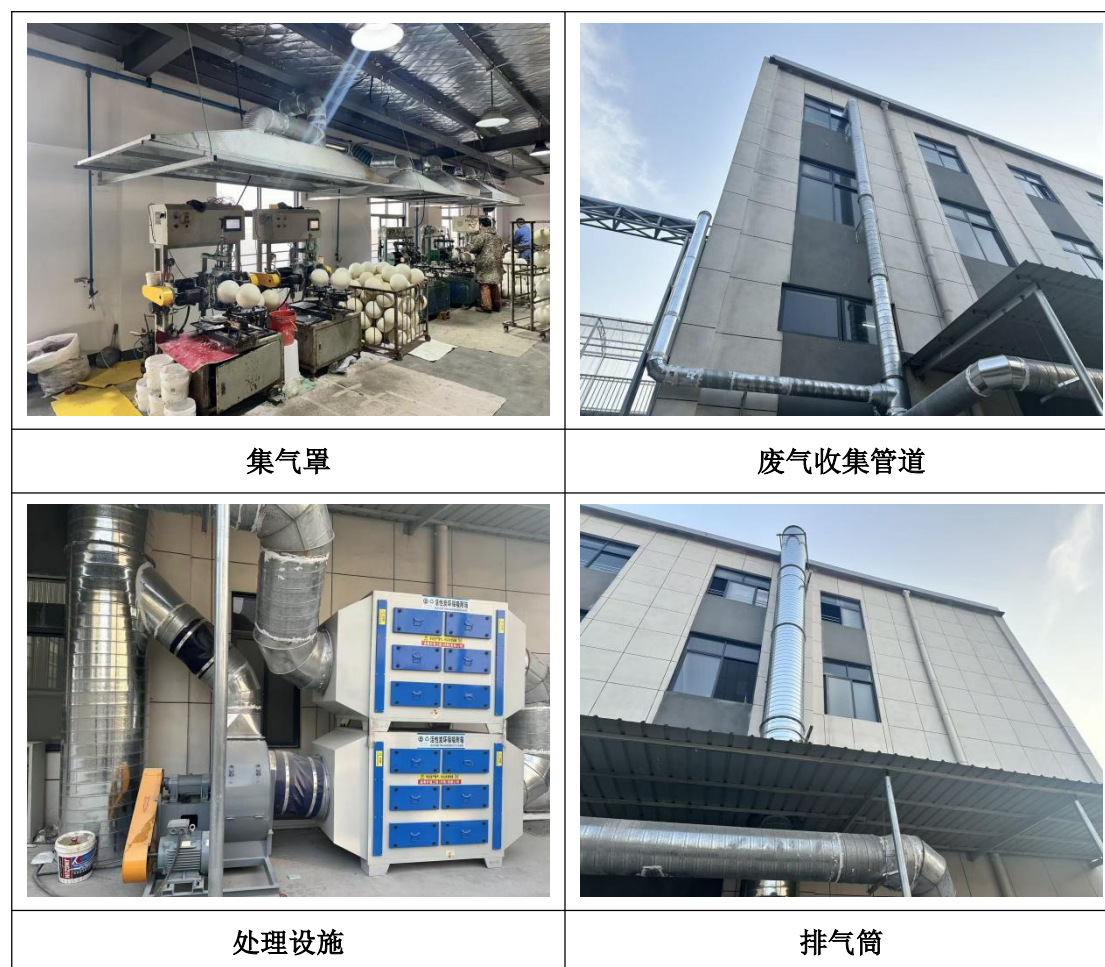
图 3.1 废气处理设施照片
