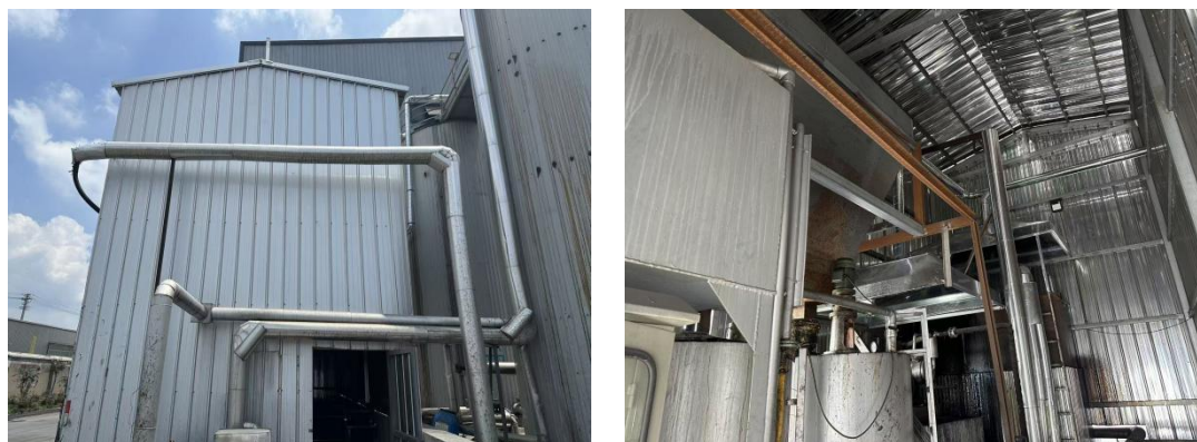
图 3-1 废气处理设施照片
