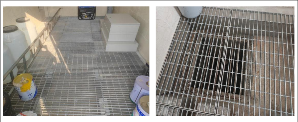
危废库设置格栅式金属隔离网板及配套防渗收集池
