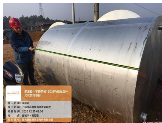
箱变事故油池
