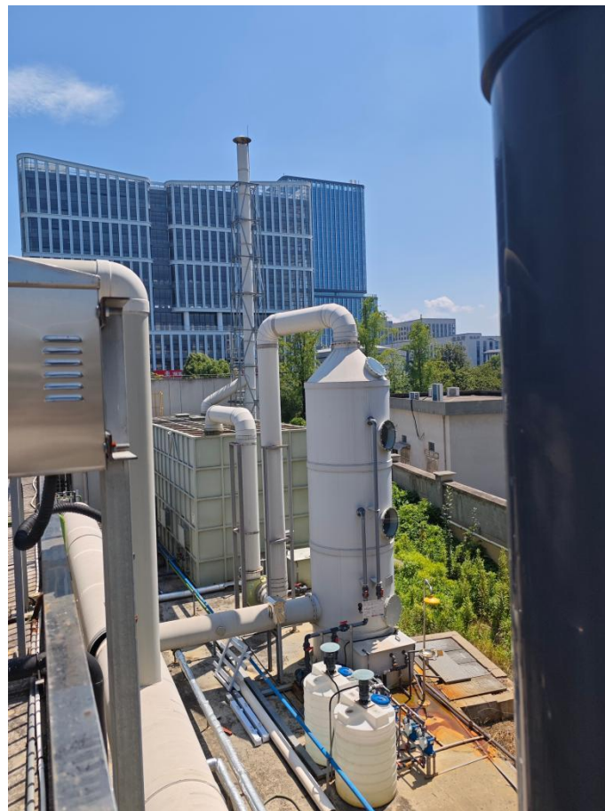
污水站废气排气筒 DA007
