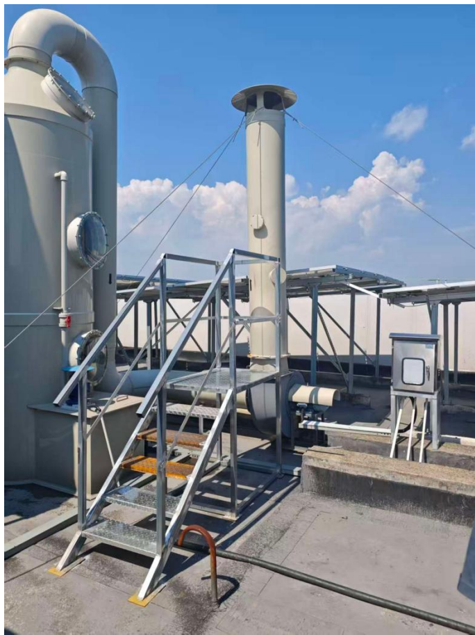
乙醇挥发废气排气筒 DA006
